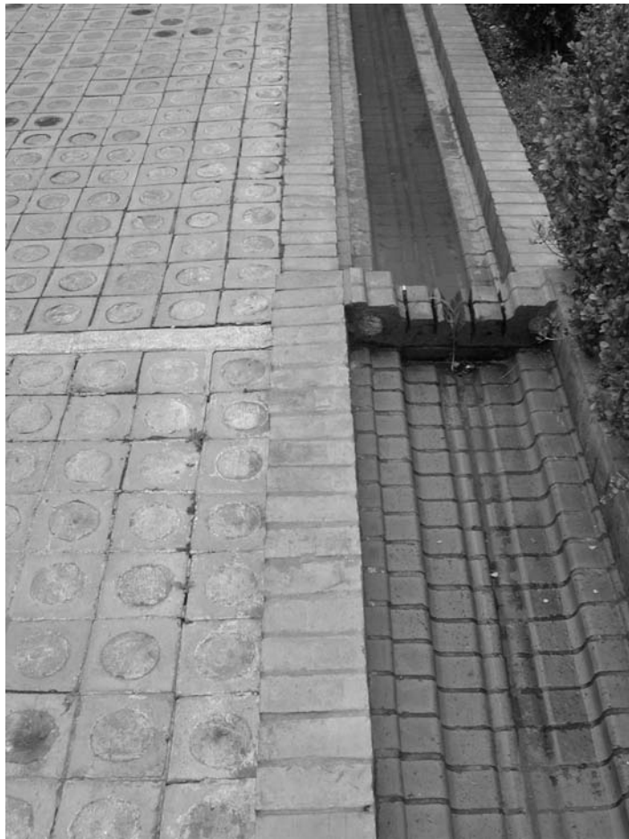
Figura 20.- Dos piezas dintel dispuestas a modo de vierteaguas y enfrentadas, para canalizar el agua, junto a pavimento cerámico perforado relleno de hormigón, para el paso, y de césped para el ajardinado.
